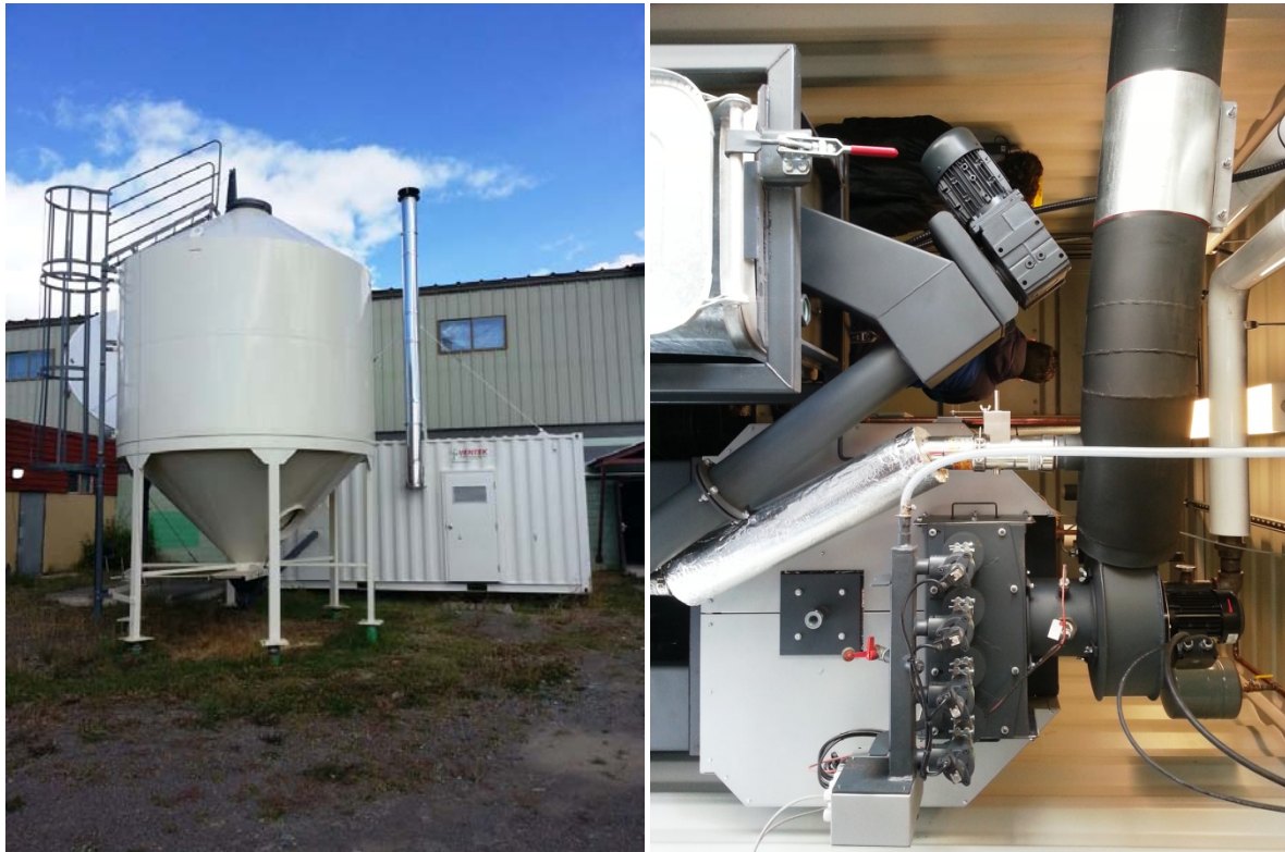
Figure 5 : Projet d'exploitation de la biomasse mis en œuvre par la Première Nation Nak'azdli, pour chauffer le centre communautaire
